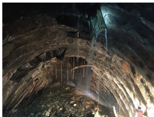
圖 3 隧道抽坍後出水情形
