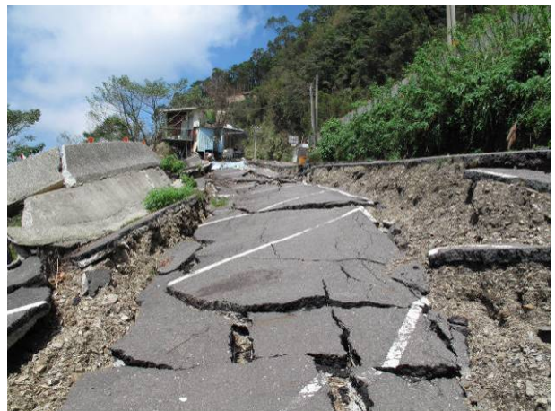
圖 17 莫拉克颱風藤枝地區崩滑破壞情形
