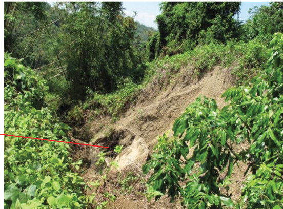
圖 20 莫拉克颱風後寶隆場址坡趾處局部崩滑
