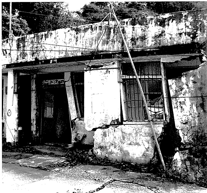
• 藤枝部落因邊坡滑動造成房屋扭曲張裂。
