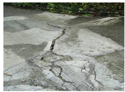
(i) 凌雲山莊旁路面開裂(2008)
