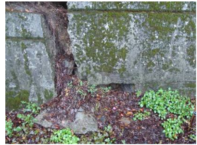
(f) 台 14 線道路旁擋土牆開裂(2008)
