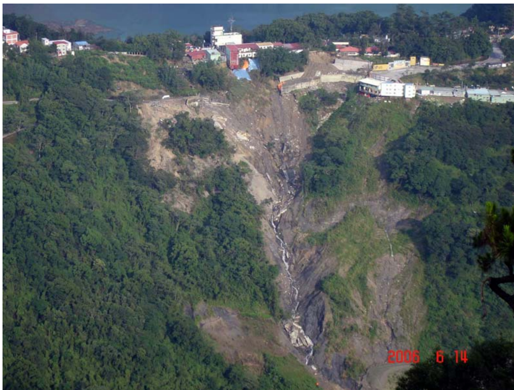
圖 2 69 豪雨引致台 14 線 79K 處道路邊坡破壞照片(公路總局第二區養護工程處，2007)
