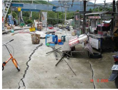
(b) 79k+100 旁民宅地坪開裂(2006)
