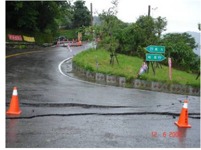
(c) 79k+200 處路面開裂(2006)
