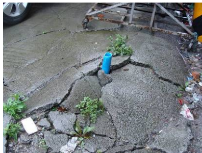
(g) 坡頂舊有觀測孔擠壓變形(2008)
