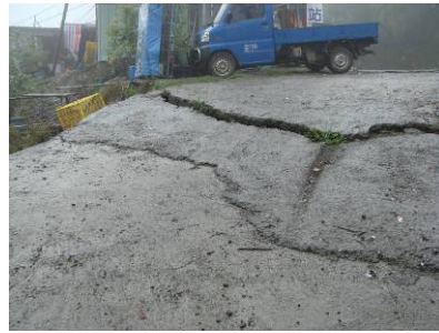
(e) 台 14 線道路旁地面開裂(2008)
