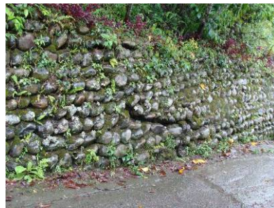
(h) 坡面漿砌擋土牆開裂(2008)
