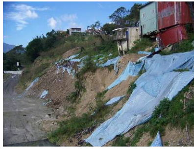
(a) 北側邊坡 69 豪雨崩塌狀況(2007)
