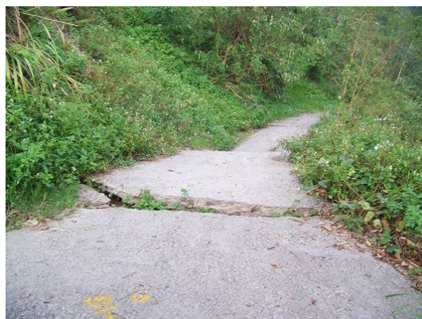
(b) 坡面產業道路下陷及開裂
