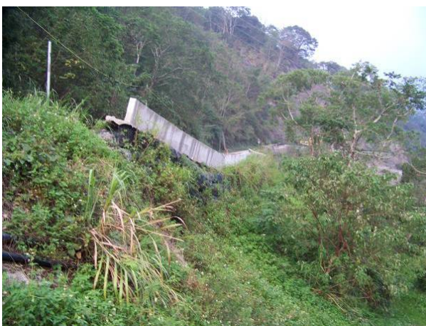
(a) 坡面通達道路明顯下陷、護欄傾斜
