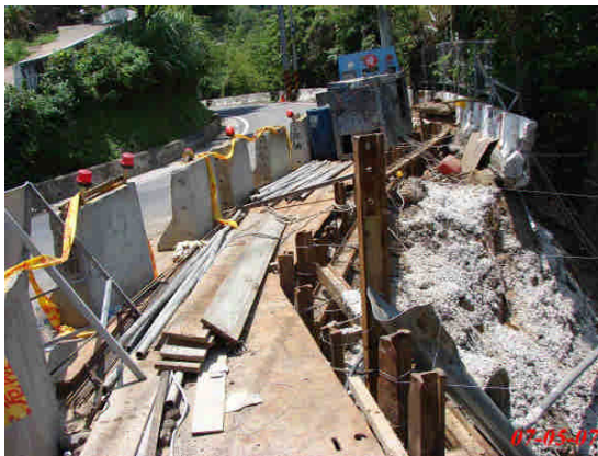
圖1 台7線道路邊坡因豪雨崩塌滑動
