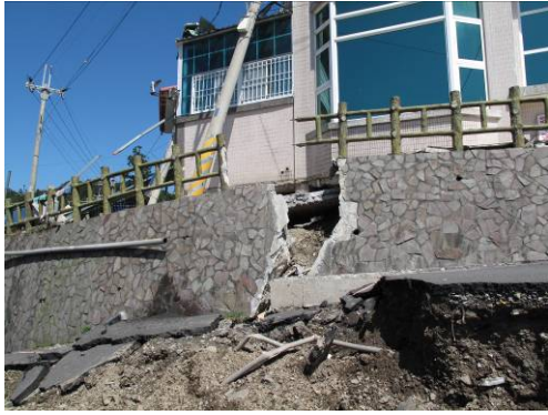
(c)建築物旁擋土牆破壞且道路塌陷 (224961, 2551727)
