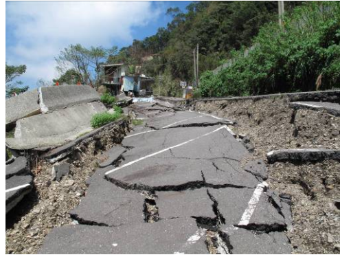
(d)西側道路塌陷產生顯著張裂縫 (224759, 2551756)
