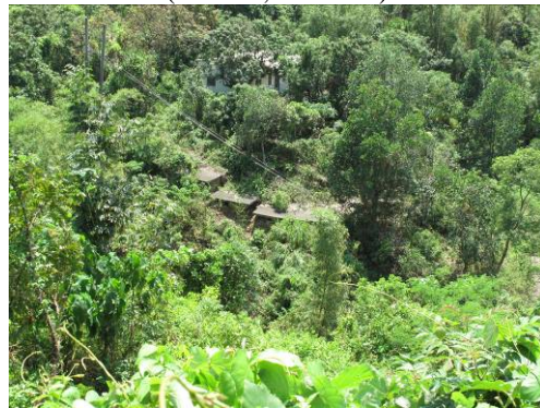
(d) 對岸道路因路基塌陷成階梯狀破壞 (206907, 2550285)
