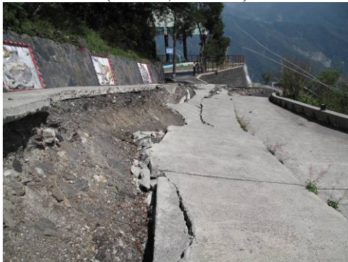
(e)坡面道路下陷，垂直落差約1 m (224167, 2515754)
