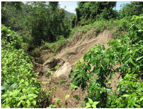
(a) 西側之產業道路下邊坡產生崩滑 (206788, 2550213)
