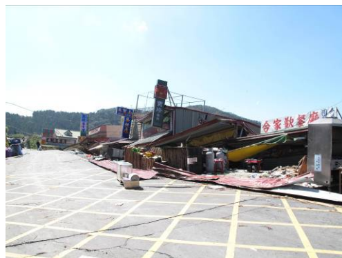
(b)東側房屋傾倒狀況，塌陷約一層樓高 (224805, 2551751)
