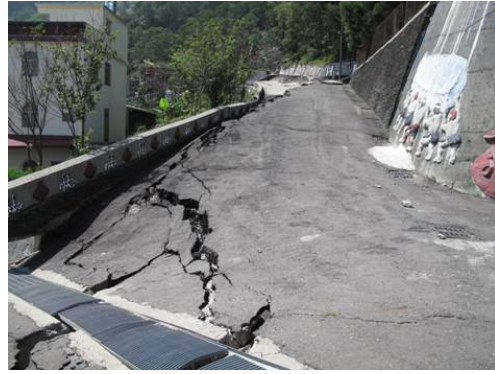
(d)籃球場旁道路張力裂縫再次張裂 (224209, 2515800)
