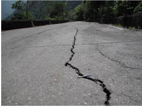
(c)上邊坡道路之張力裂縫 (224086, 2515684)
